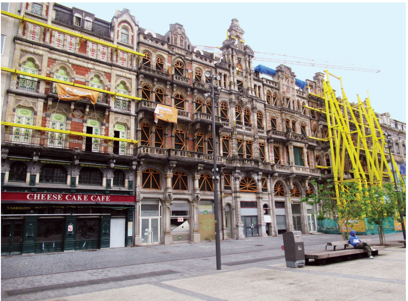
↑ Photo 1 Opération avec conservation des façades existantes place de Brouckère. Sortie du stock de bureaux (mai 2023) Foto 1 Operatie met behoud van de bestaande gevels op het Brouckèreplein. Verwijdering uit de kantoorvoorraad (mei 2023)
