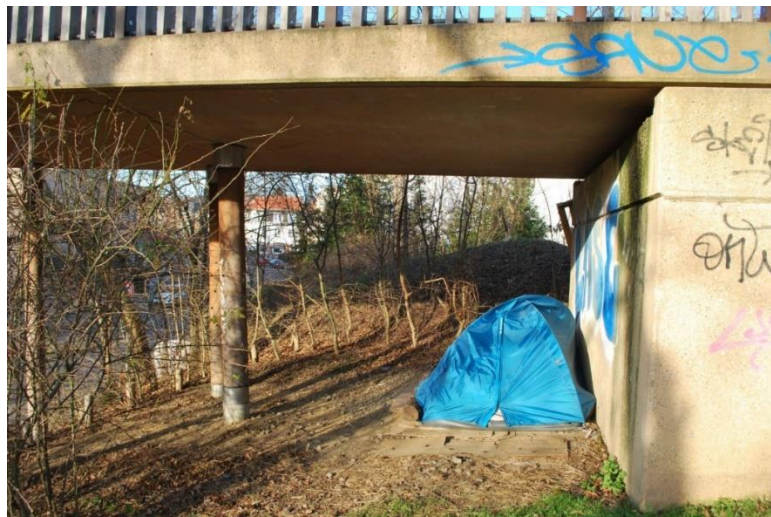
Afbeelding 412: Aanwezigheid van een tent onder het wandelpad langs de spoorweg ter hoogte van het kruispunt met de Watermaalse Steenweg (foto ORG 2 , 2016)
